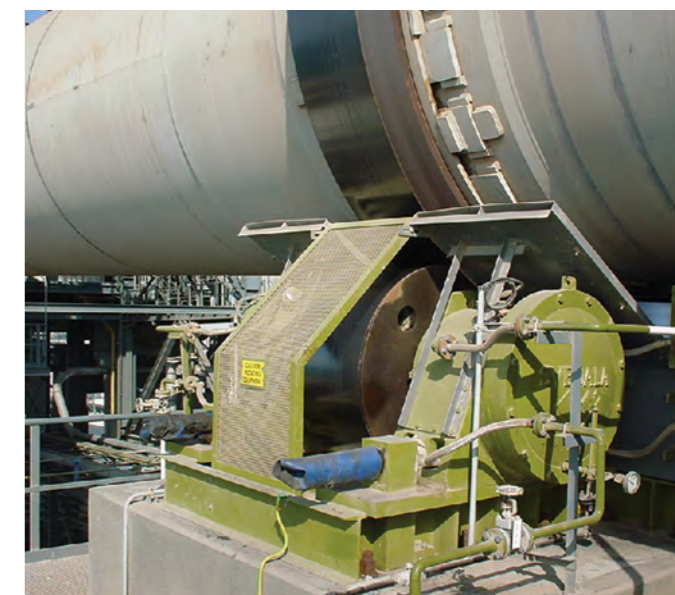
Усиленная несущая конструкция
