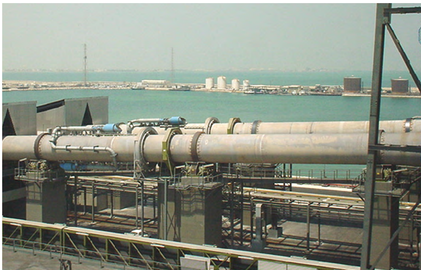
Две установки обжига кокса в Бахрейне
